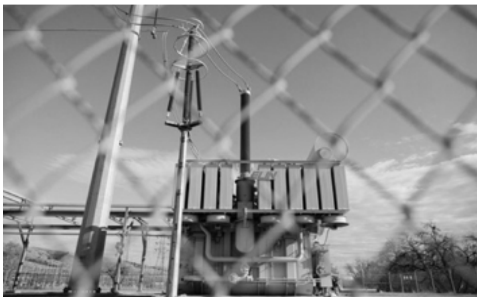
Sjutton transformatorer nära Silicon Valley kunde angripas med automatvapen på utvalda platser utanför stängslet. Förövarna siktade mot kylanläggningens oljebehållare. Innan hade de kapat kommunikationerna (tele och internet) i närbelägna kulvertar.
